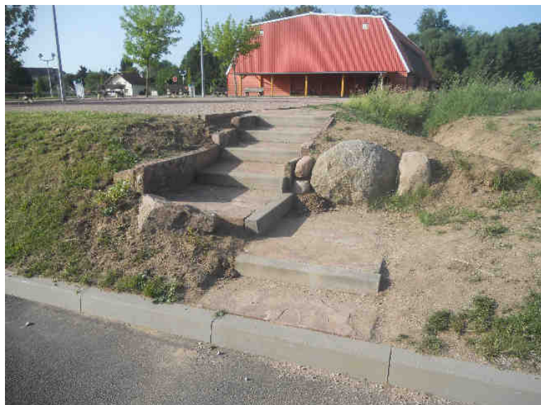
Réalisation d'un escalier d'accès entre le Groupe Scolaire et le Centre sportif et culturel
