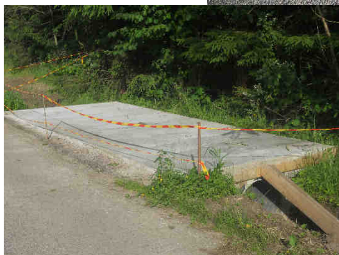
Plate-forme béton pour accueillir les bacs de regroupement (ordures ménagères) secteur du Chenat
