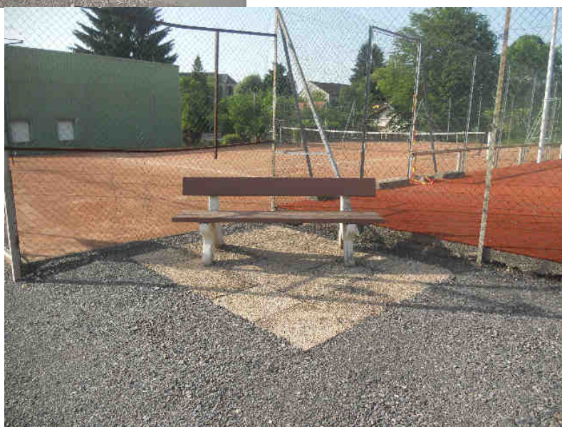
Installation d'un banc public sur une plate-forme en dalles près des tennis
